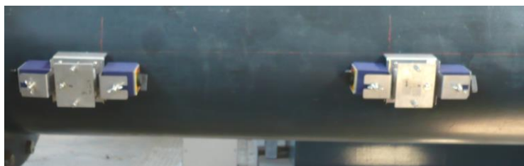
(3) センサ取付け状況
