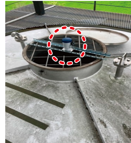
● 検尺口(マンホール)に設置
