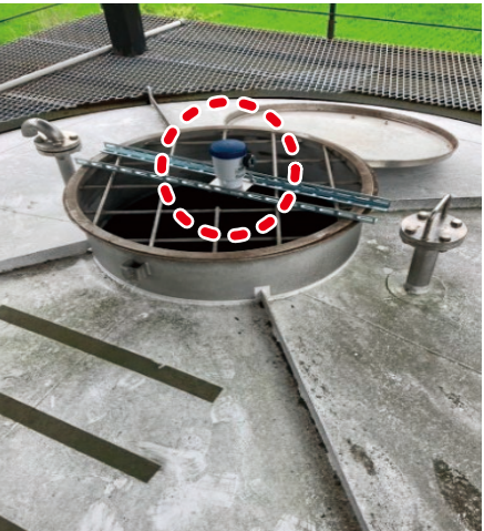
● 検尺口（マンホール）に設置
