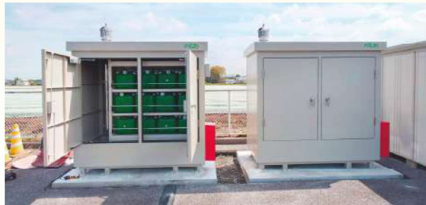
2台隣接 設置事例
