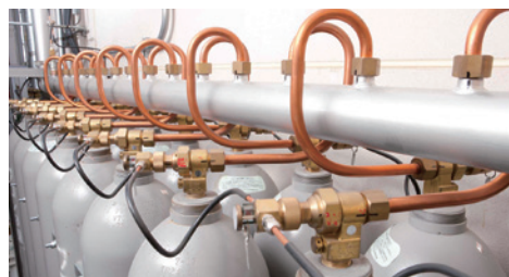
ガス系消火設備
