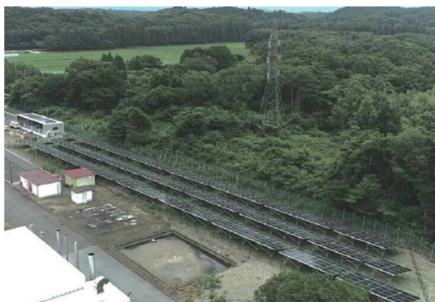
那須工場の太陽光発電設備
