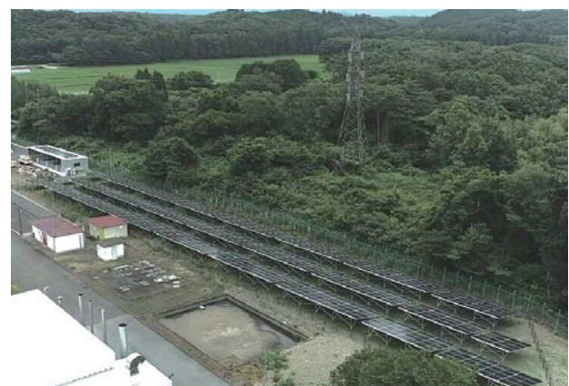
那須工場の太陽光発電設備
