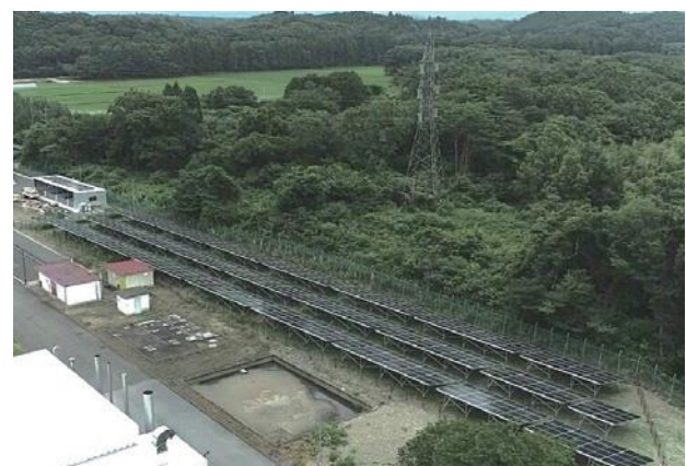
那須工場の太陽光発電設備
