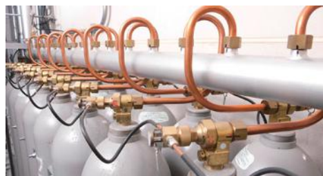
ガス系消火設備
