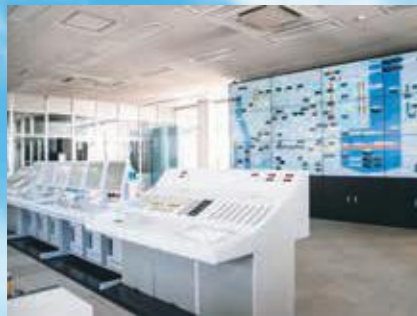
利根導水総合事業所内の中央操作室 ここでは24時間の監視体制が敷かれ、利根導水の安全を管理しています。
