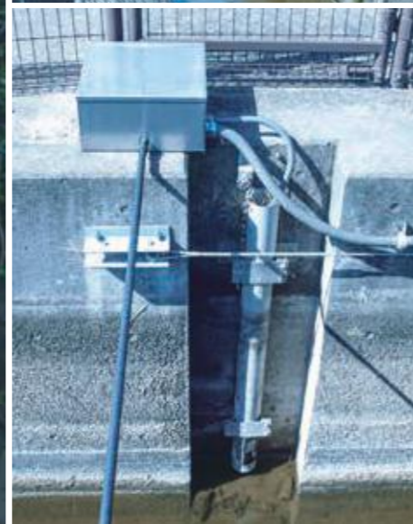
農業用水路に設置された超音波流量計の流速センサ。
