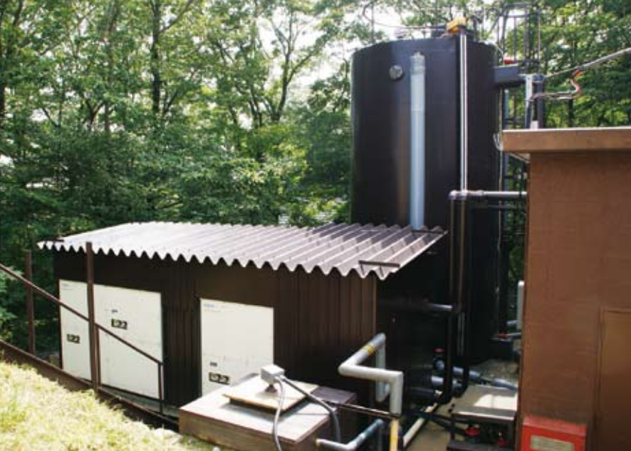
貯湯槽および熱交換器（ヒートポンプ）建屋
